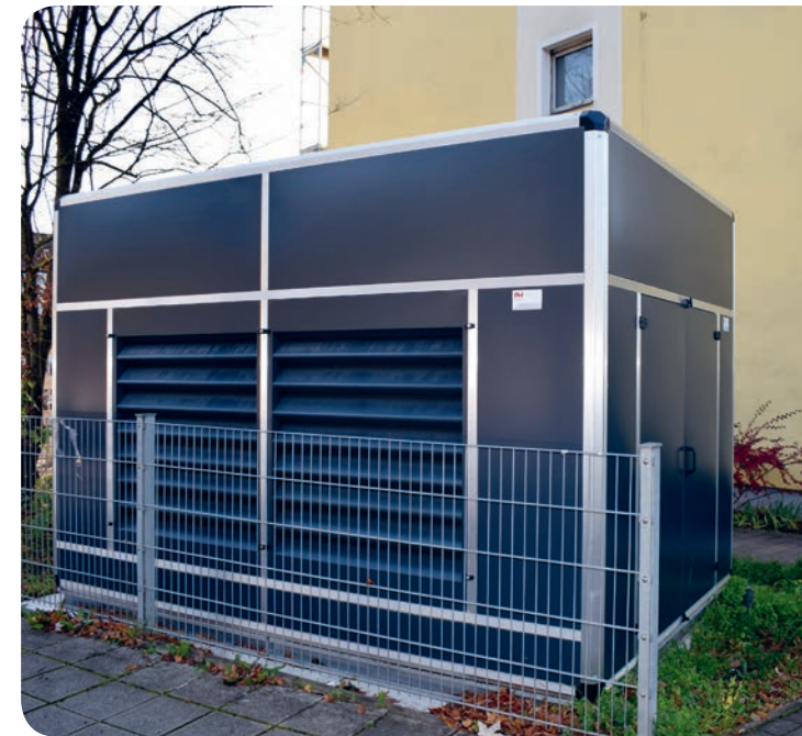
Wärmepumpe an der Julius-Loßmann-Straße.
