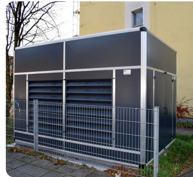
Wärmepumpe an der Julius-Loßmann-Straße.
